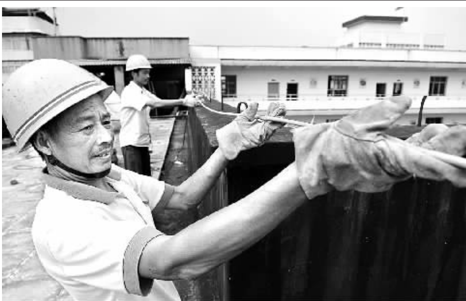
6月16日,宜昌市气象局防雷工程施工人员在红星路小学教学楼顶安装避雷装置。当日,湖北宜昌中小小学校安装避雷装置工程正式启动,首批20多所中小小学校将陆续安装避雷装置。 新华社发
